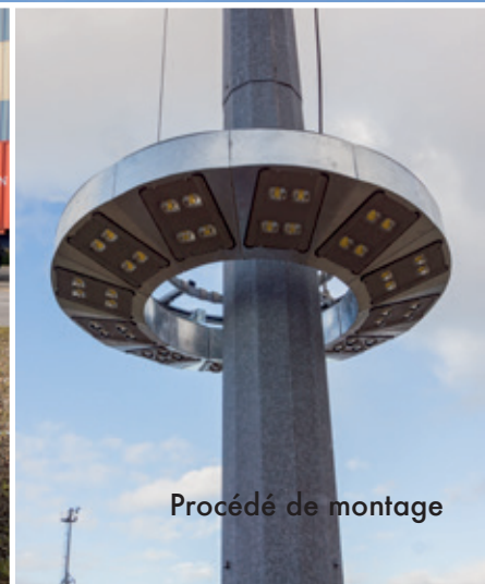
Installation au Port de Vigo (Spain)
